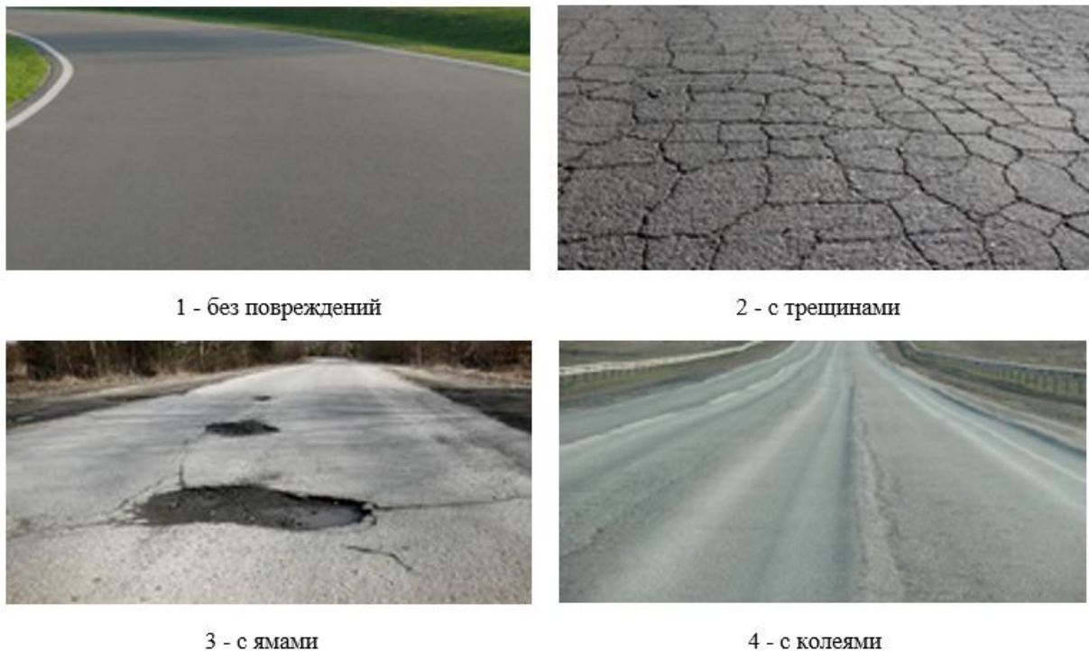
Рис. 1 – Фотографии каждого вида дорожного состояния: 1 – без повреждений, 2 – с трещинами, 3 – с ямами, 4 – с колеями
