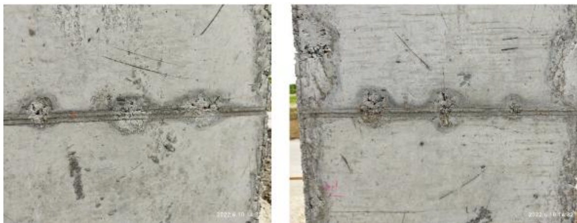
Рис. 4. – Дефекты железобетонных колонн второй заливки
