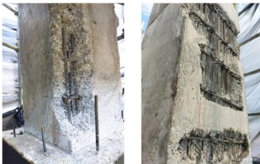
Рис. 3. – Дефекты железобетонных колонн
