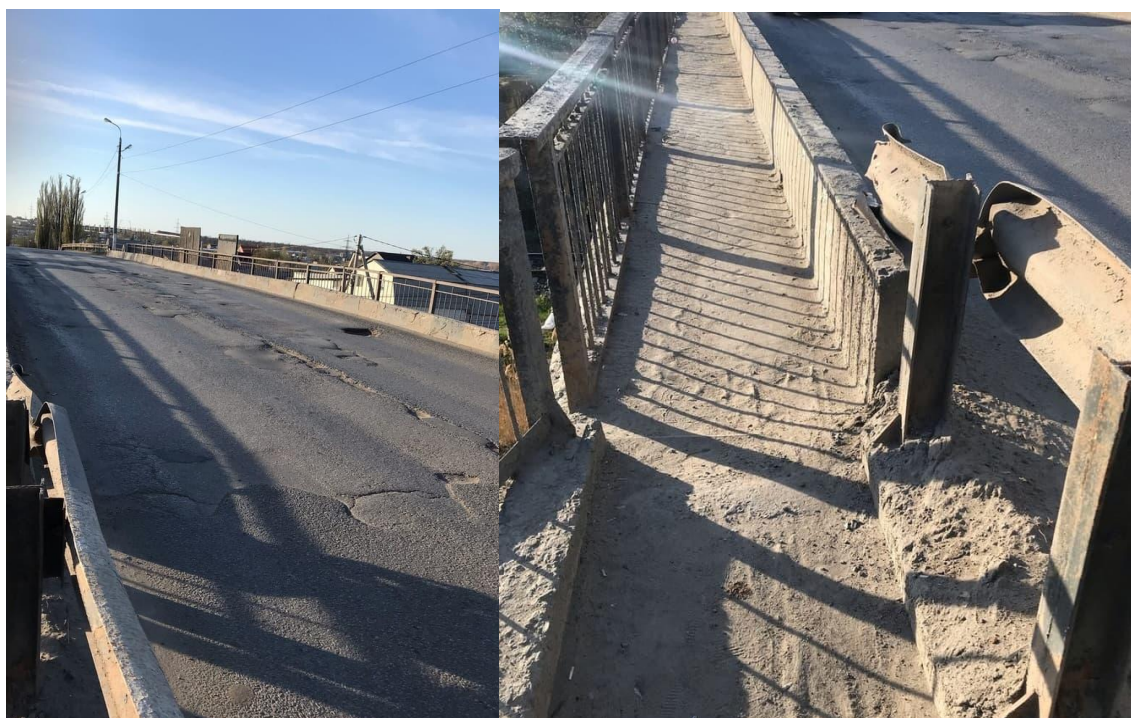
Рис. 3. Разрушения и дефекты мостового полотна (фото авторов).
