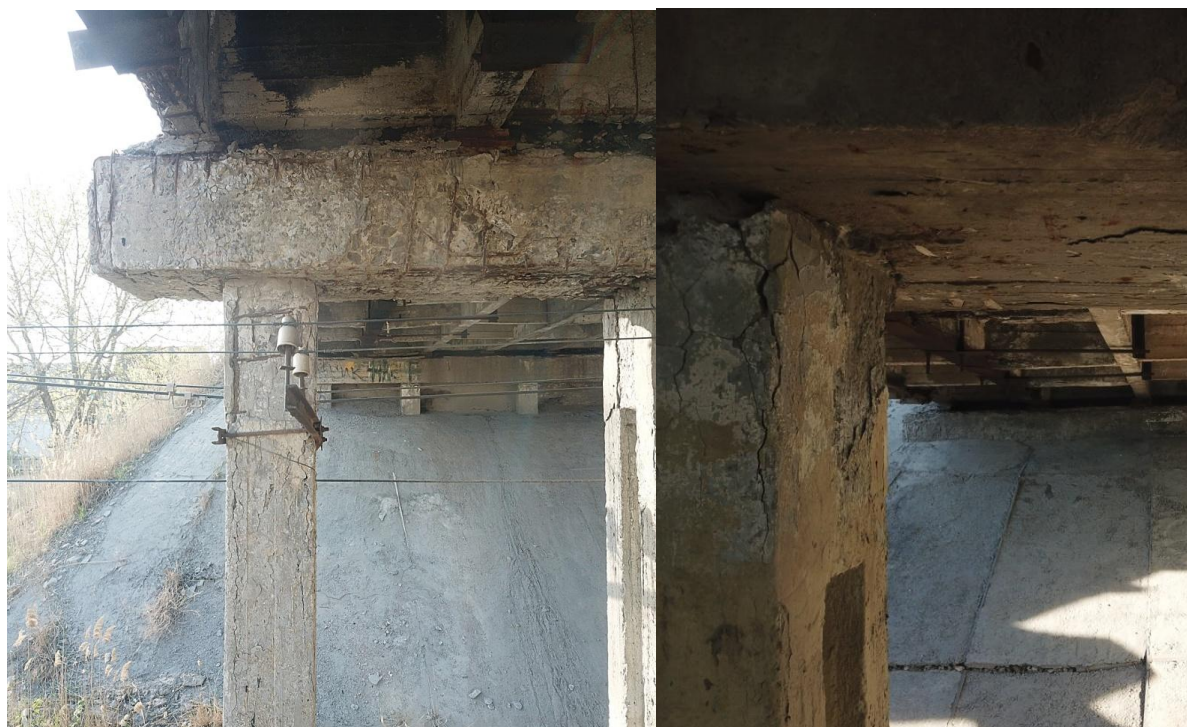
Рис. 3. Выявленные дефекты опор моста (фото авторов).
