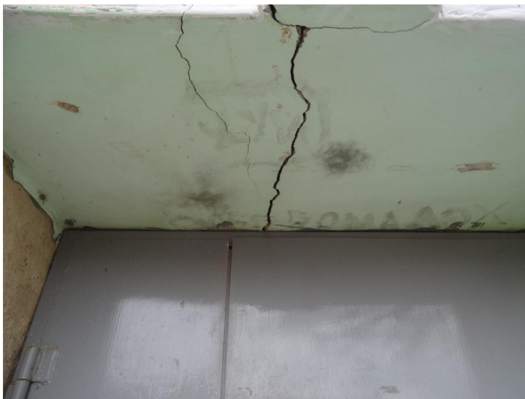
Рис. 3. - Трещина на перемычке над главным входом в объект.
