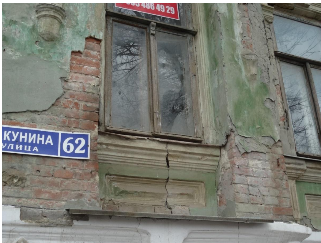
Рис. 2. - Трещина в подоконной части стены южного фасада объекта.
