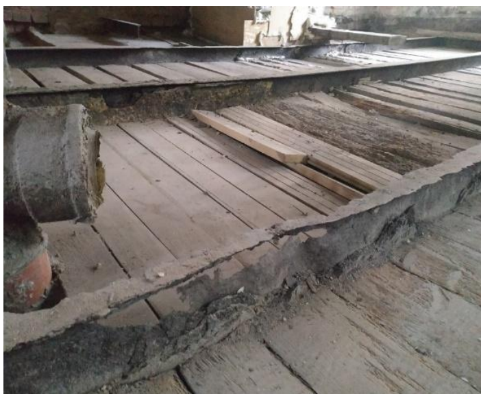
Рис. 1. - Металлическая балка перекрытия, подтверждена коррозии вследствие протечек в местах инженерных коммуникаций (санузлы, кухни, места прохода стояков отопления), на первых и цокольных этажах (сырые подвалы), на последних этажах (протекающие кровли)
