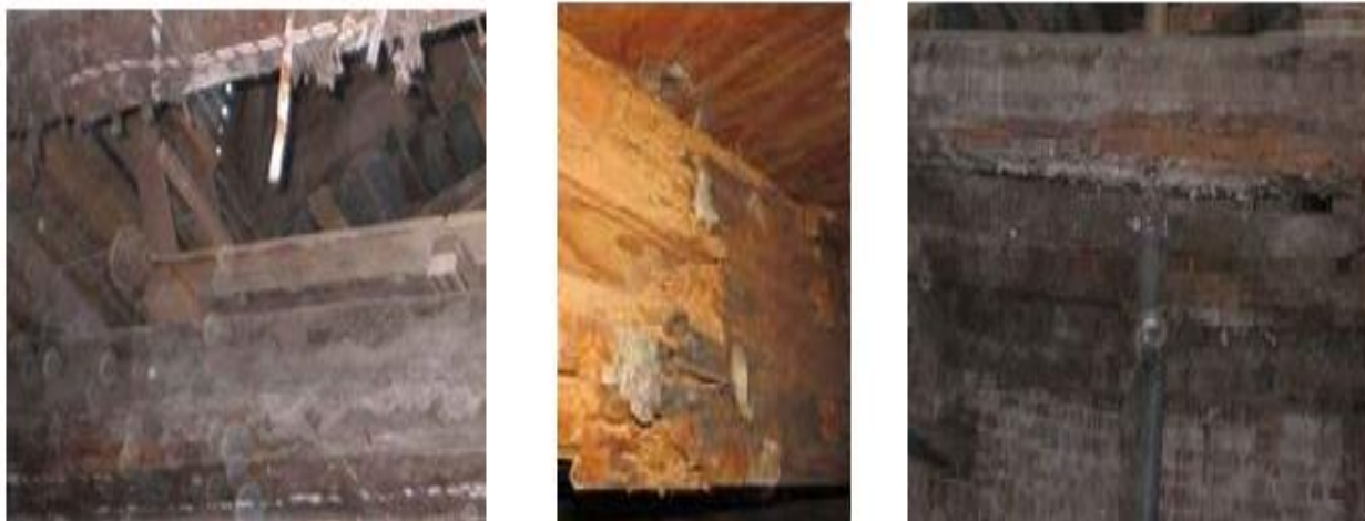
Рис. 2. - Дефекты балок перекрытия в зданиях старой постройки (гниение; плесень; расслоение, трещины и т.п.)
